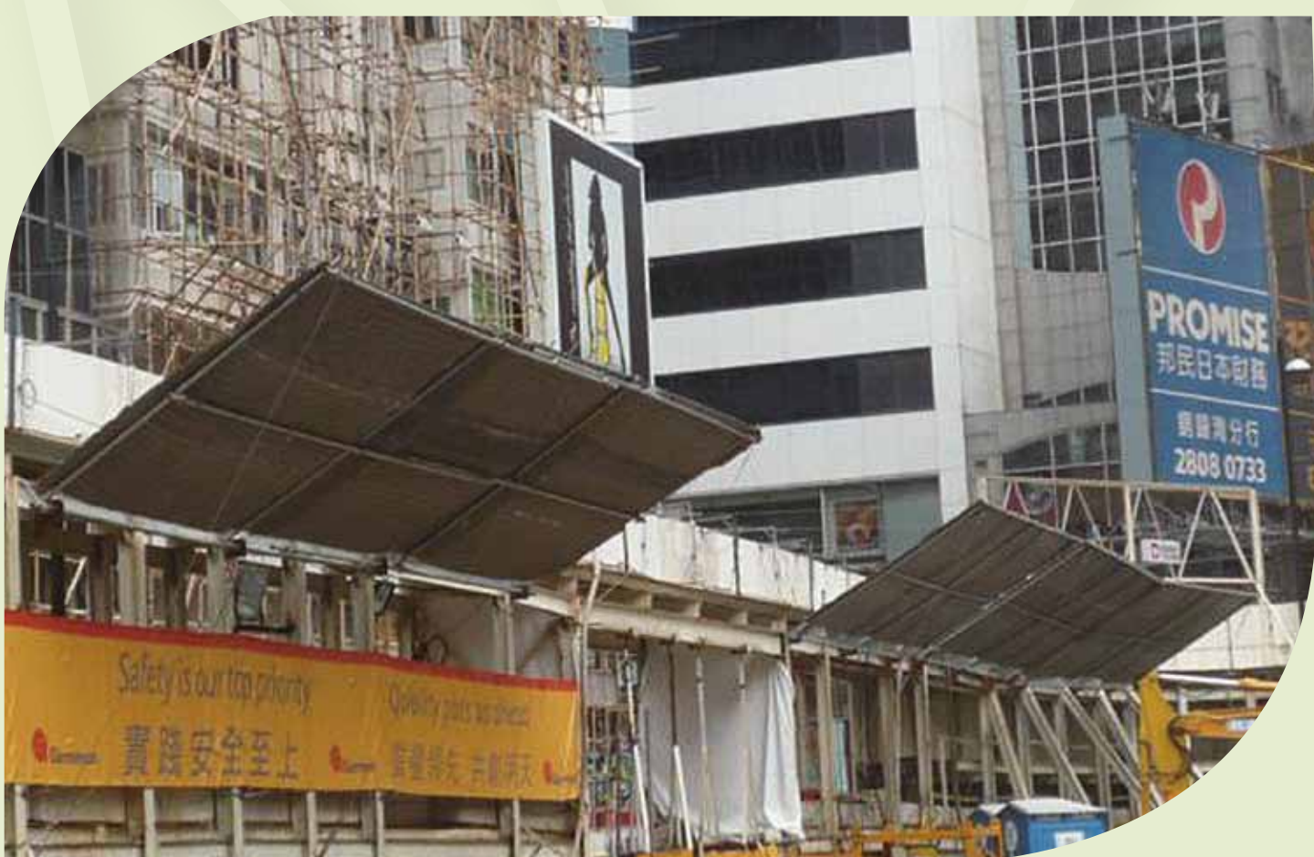
使用隔音屏障以減低噪音 Using noise barrier to reduce noise
