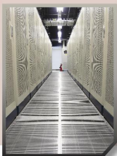
在數據中心和辦公室採用符合能源效益的設計和設備，有助降低能源用量。 The use of energy-efficient systems in data centres and office helps reduce energy consumption.
